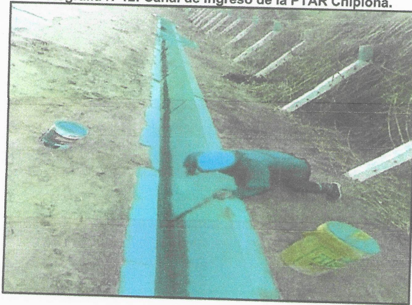
Fotografía N°12: Canal de Ingreso de la PTAR Chipiona.
