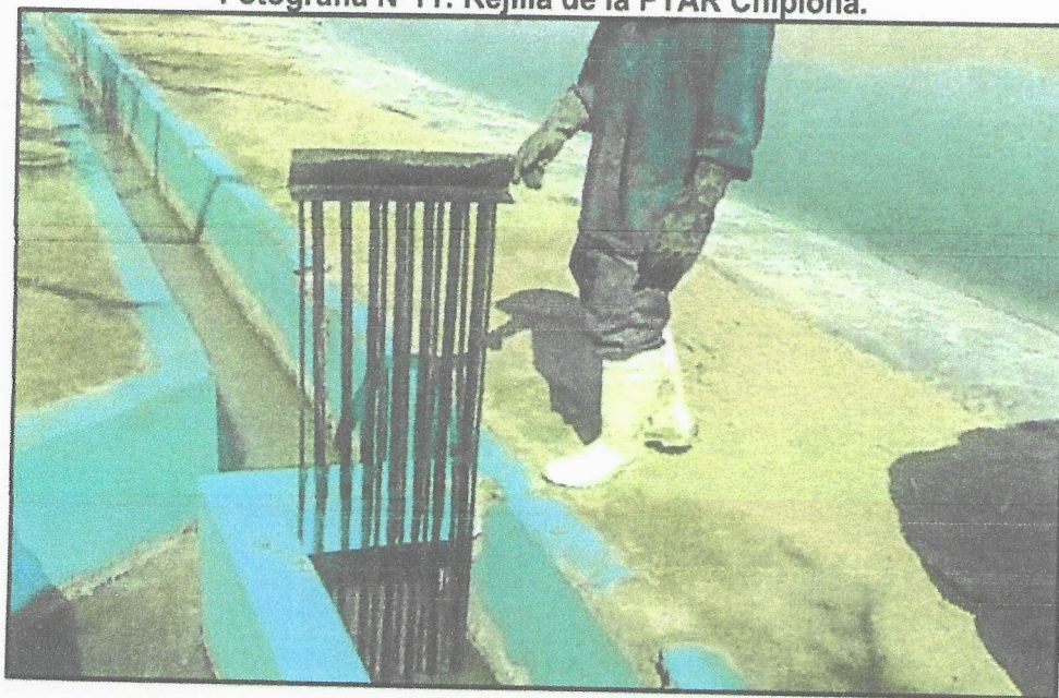
Fotografía N°11: Rejilla de la PTAR Chipiona.
