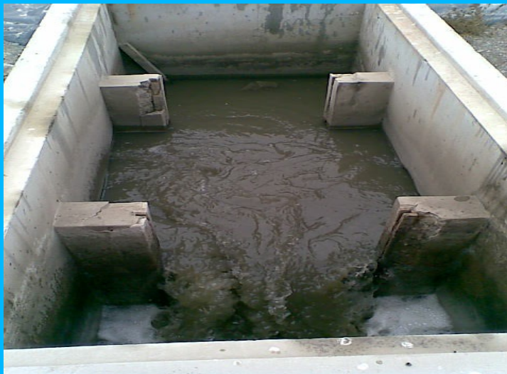
Ingreso de Aguas Servidas a las Lagunas
