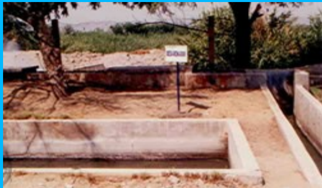
Componentes del Sistema de las Lagunas de Cachiche, Buzón principal de descarga de Afluentes del emisor principal, Cámara de rejillas, Medidor Parshall, desarenador y canaleta de distribución directo hacia la Laguna N° 1
