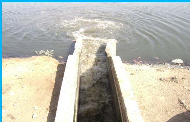
Ingreso de Aguas Servidas a las Lagunas Primarias
