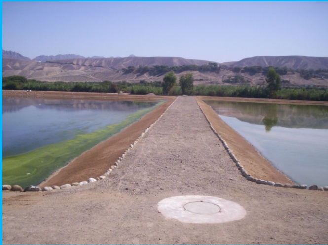
Lagunas de estabilización ubicadas en el Sector Jauranga
